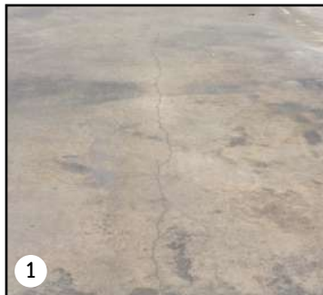
รอยร้าวก่อนซ่อม
