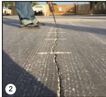
ตัดขยายรอยร้าวและฝังเฟอร์โรสตัด 6 มม. เว้นระยะ 20 ซม.
