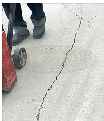
รอยร้าวคอนกรีตก่อนฉีดยึด
